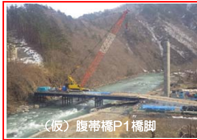
(仮)腹帯橋P1橋脚で、締切鋼矢板の打設を行っています。
