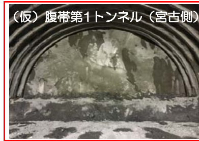
(仮)腹帯第1トンネルの掘削を行っています。全長1,774mのうち528mまで進んでいます。
