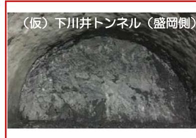
(仮)下川井トンネルの掘削を行っています。全長2,050mのうち856mまで進んでいます。
